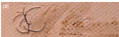
Abbildungen: [1] Hagelkörner; [2] & [3] Beschädigte Flachdachoberflächen
