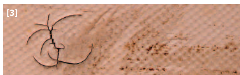
Afbeeldingen: (1) Hagelstenen; (2) & (3) Beschadigde dakoppervlakken
